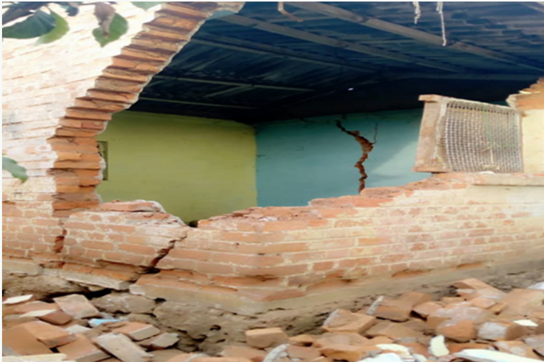
Fig. n° 5. Effondrement des maisons à la Gécamines Kolwezi sur l'avenue de la mine - coin de la chapelle
